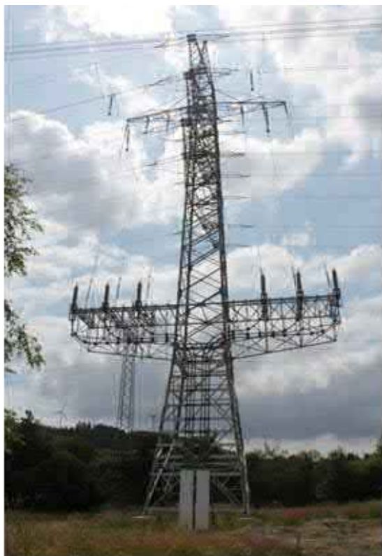
Abbildung 14: Beispiel eines Übergangsmastes mit Kabelendverschlüssen
