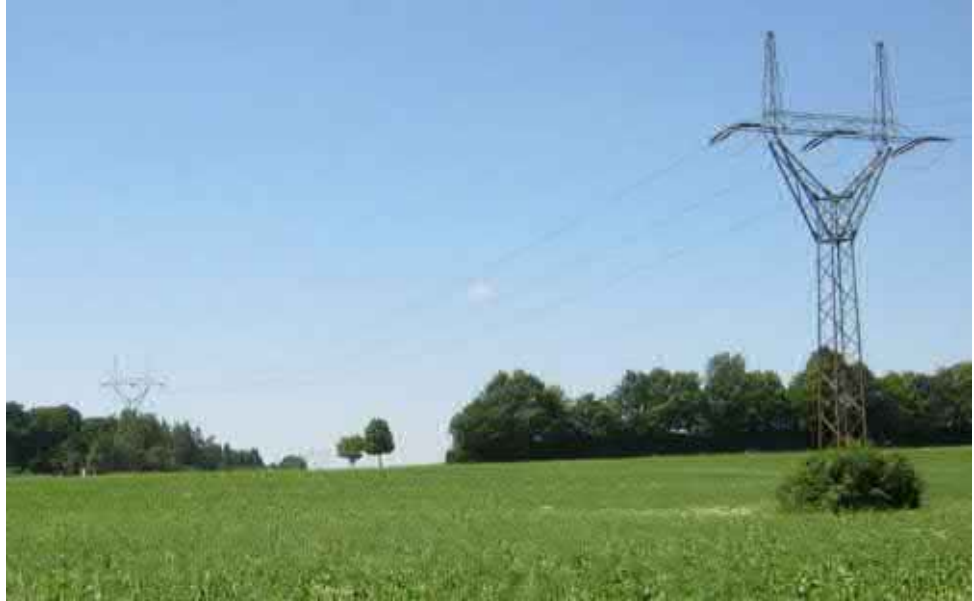
Abbildung 1: Bestehende 110-kV-Freileitung Balzhausen-Meitingen Abschn. 8
